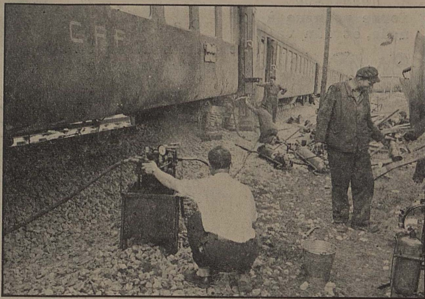
A côté de grues puissantes arrivées dans la journée à Gland, les équipes techniques utilisèrent du matériel moins spectaculaire mais très efficace pour remettre les wagons sur les rails. On voit ici au travail une petite pompe-élevatrice d'une puissance remarquable.
